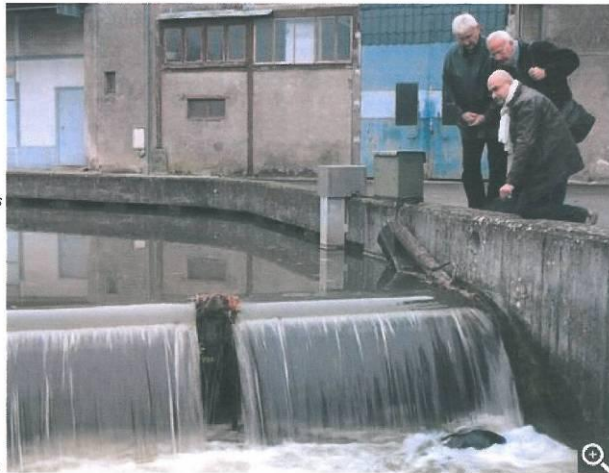
Ce barrage sur la Cisse à Chouzy sera lui aussi abaissé si besoin : la municipalité propriétaire s'attend à quelques réflexions.
